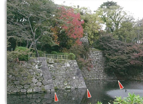
⑯ 龍城堀石垣 □ 連続する3重の石垣の隅角部を見ることができます。龍城堀の石垣には何度も補修された痕跡があります。
